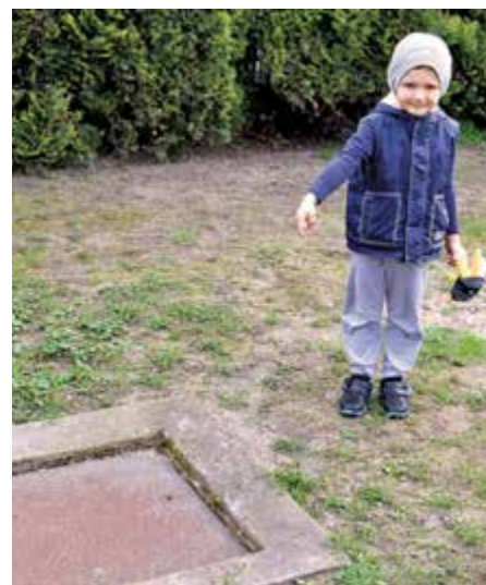
Dopiero po zdarzeniu szambo zostało zabezpieczone
